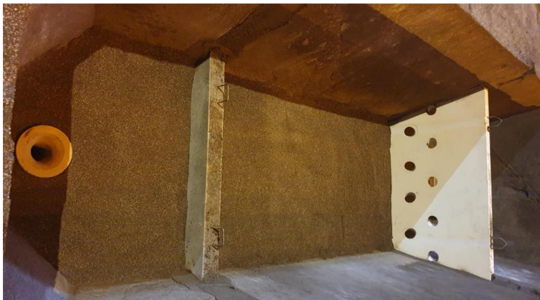
Obr. 147 Uloženie vystrojenia (hrádzok) v medzipanve v prevádzke
