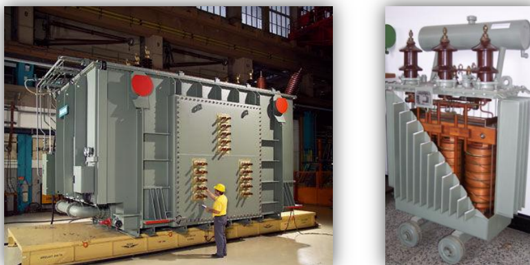
Obr. 2 Trojfázový pecný transformátor v prevádzkových podmienkach elektrooceliarne
